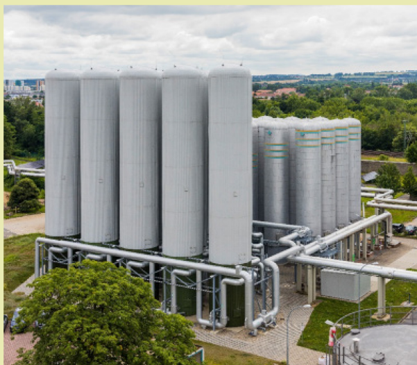
Almacenamiento térmico en la Reick Innovation Power Plant, SachsenEnergie, Killig 2021.
